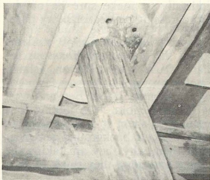
ENDROIT DANGEREUX — Les poutres du toit prendront probablement feu lorsque les tuyaux du poêle chaufferont.
